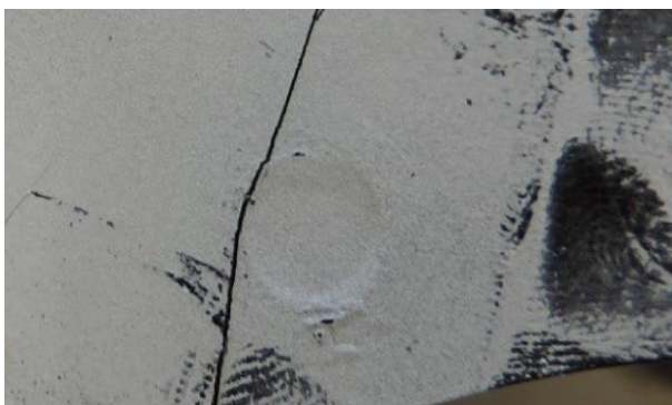
Fig. 2. Photographie d'une zone de la pièce (correspondant au modèle de la Fig. 1) après essai.
