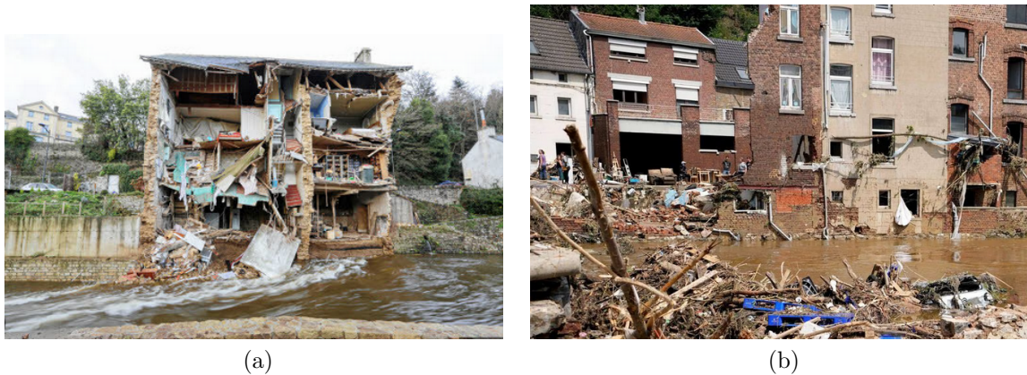
FIGURE 1.21 : Bâtiments effondrés. (a) A Quimperlé, quelques jours après les épisodes du 23 décembre 2013 (Source : https://www.letelegramme.fr/finistere/quimperle-29300/spanquimperlespan-la-maison-seffondre-dans-la-riviere-2032538.php ). (b) A Liège, après les inondations causées par des pluies diluviennes en juillet 2021 (Source : https://www.lalibre.be/belgique/societe/2021/07/17/intemperies-plusieurs-corps-retrouves-le-deblayage-se-poursuit-dans-les-communes-liegeoises-Z435A6VLQNFD TGYY6N46MOVUOI/ . Consultés le 27/07/2023)
