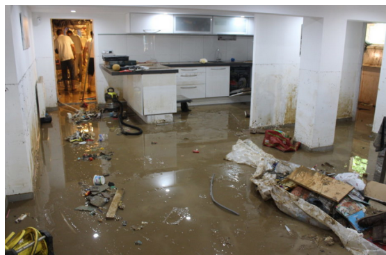
FIGURE 1.18 : Dommages causés par une inondation dans une maison : maison dévastée par plus d'un mètre d'eau à Juilly durant les inondations qui ont touché l'Ile-de-France en 2021 (Source : par Lilian Pouyaud/La Marne, https://actu.fr/ile-de-france/juilly_77241/en-images-victimes-des-inondations-des-habitants-de-juilly-ont-tout-perdu_42349372.html . Consulté le 27/07/2023).
