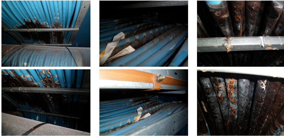
FIGURE 1.2: Câbles localement endommagés (images EDF)
